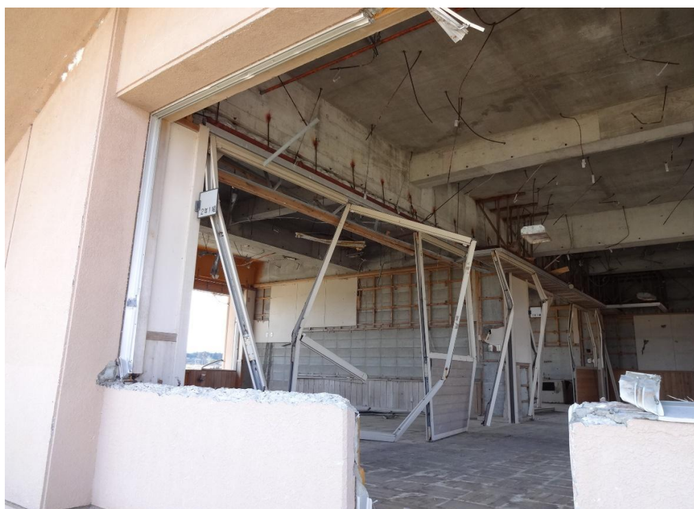
(校舎の外から撮影した写真。教室の被害状況が見て取れる)
