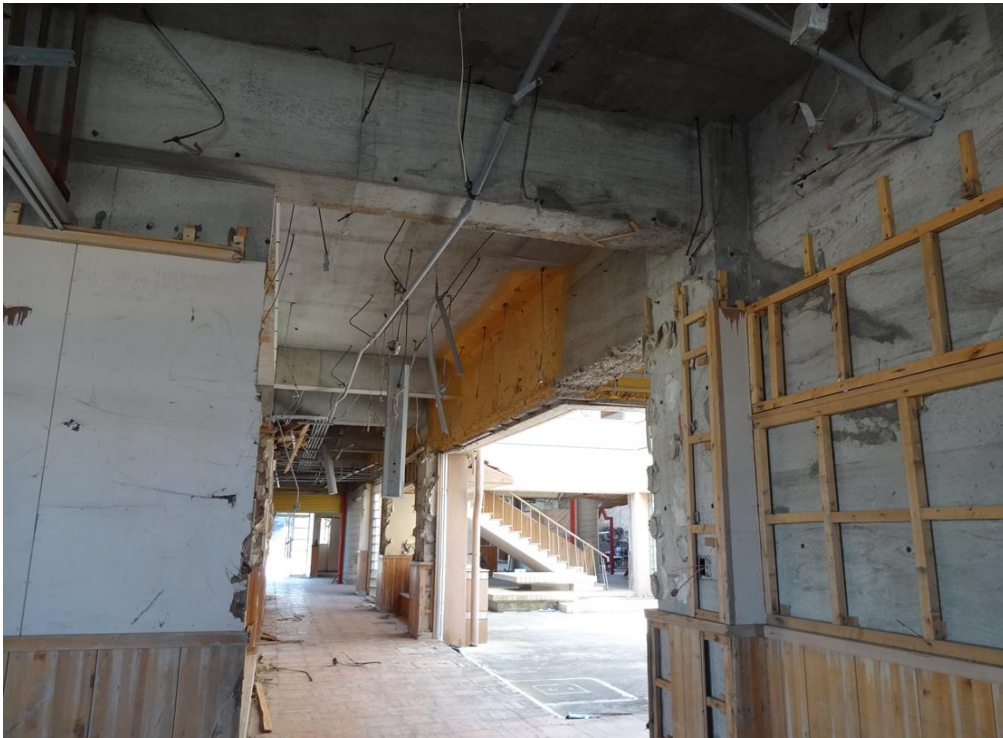
(建物の中で撮影した写真。階段と壁面の骨組みの他はほぼ全て津波に流されている)
